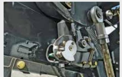
Електрическа система за свързване
